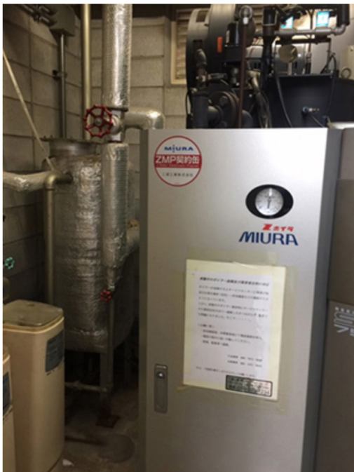
燃焼排熱で給水を予熱するボイラー
